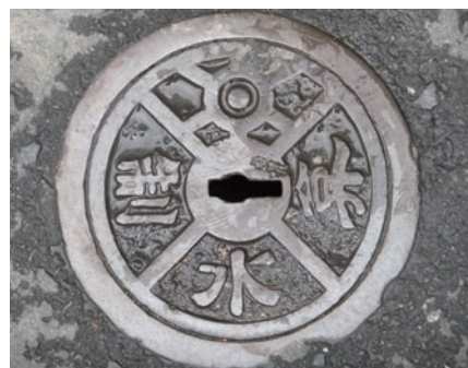
図3 制水弁 板橋区南町22番に現存するハンドホール。 昔の東京都のマークがついている。
